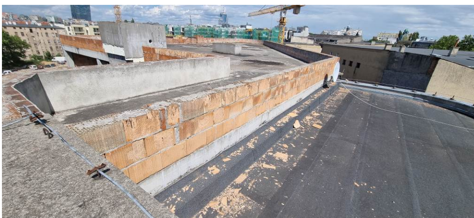
FOT. 8 – Zanieczyszczona połać dachowa oraz zdegradowana, niewykończona ściana attykowa sąsiedniego budynku
