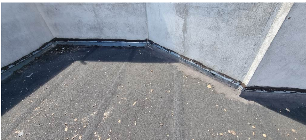
FOT. 4 – Widok zdegradowanych obróbek blacharskich ściany attykowej
