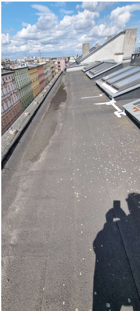
FOT. 13 – Widok zastoisk wody w obrębie koryta odwodnieniowego przy ścianie attykowej
