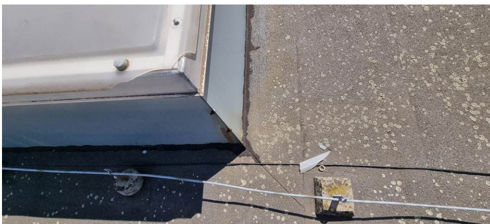
FOT. 9 – Uszkodzona obudowa wyłazu dachowego, nieprawidłowo wykonanie uszczelnienie kołnierza okna wyłazowego
