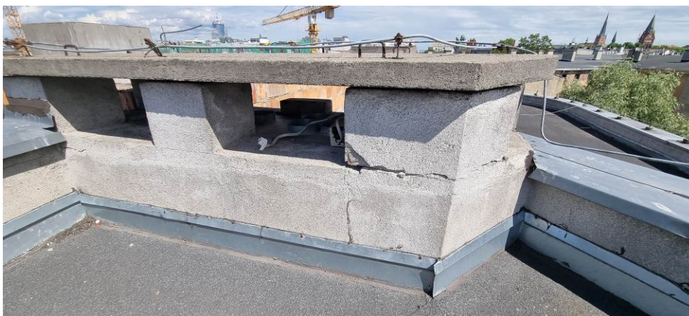
FOT. 7 – Wadliwe uszczelnienie oraz zakończenie obróbki blacharskie ściany attykowej przy kominie, uszkodzona ściana kominna
