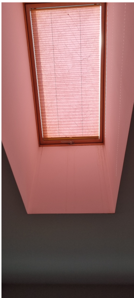
FOT. 15 – Widok zacieków w obrębie ścian
