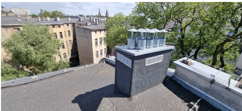
FOT. 10 – Widok nieprawidłowo wykonanych wywiewek wentylacyjnych oraz kratki zabezpieczających
