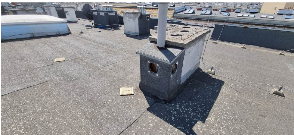
FOT. 6 – Widok brakujących wywiewek dachowych oraz kratek zabezpieczających na kominach
