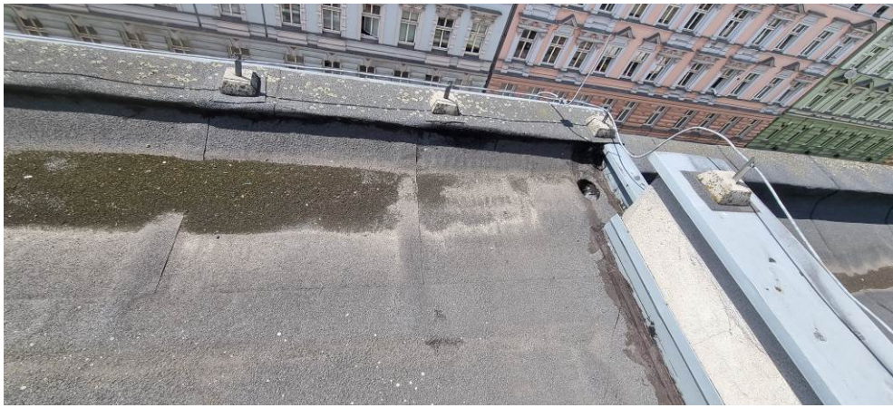
FOT. 12 – Widok wadliwie wykonanego wpustu odwodnieniowego oraz zastoisk wody w obrębie koryta odwodnieniowego
