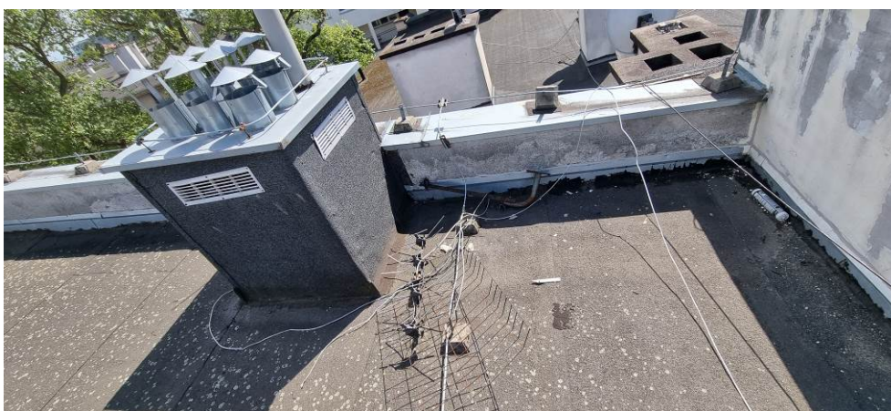
FOT. 11 – Widok zdegradowanej instalacji odgromowej oraz telekomunikacyjnej
