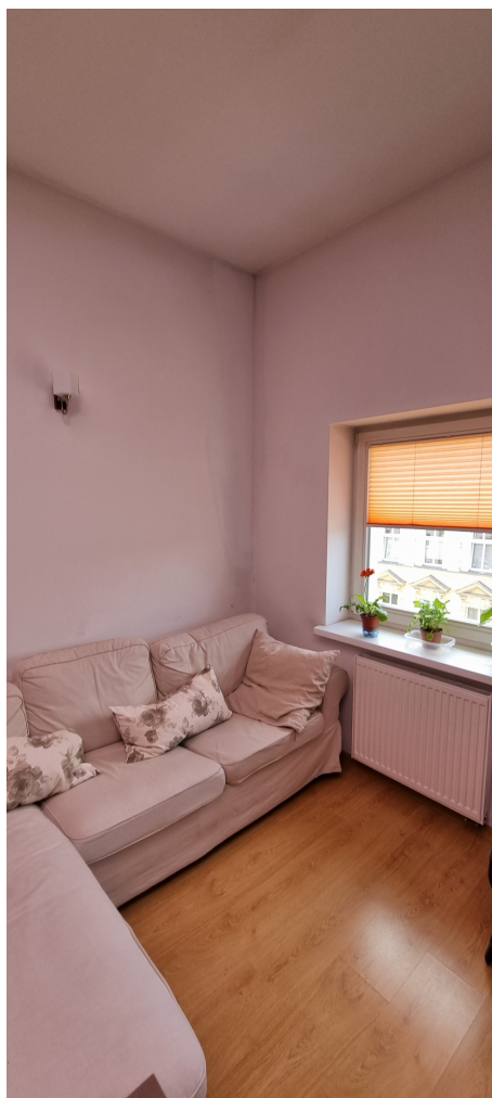
FOT. 16 – Widok zacieków w obrębie naroża ściany zewnętrznej
