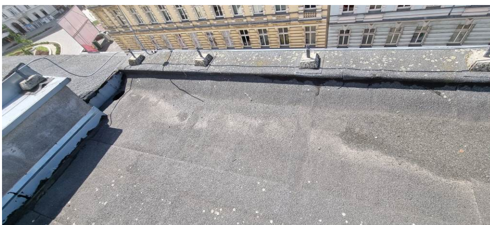
FOT. 12 – Widok wadliwie wykonanego wpustu odwodnieniowego oraz niezabezpieczonej obróbką blacharską ścianą attykową.
